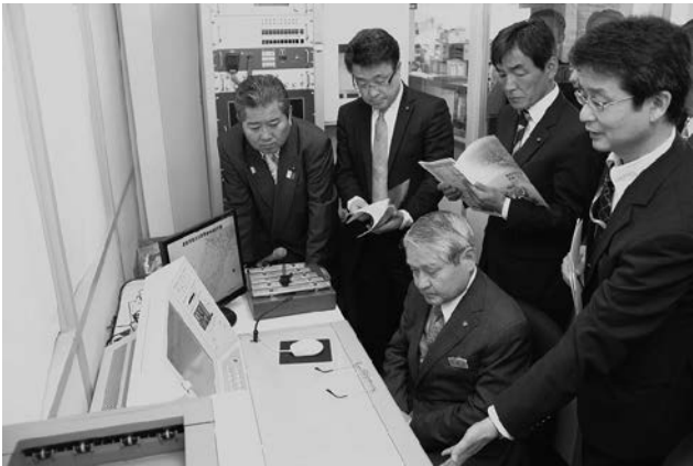
市役所に設置された防災行政無線
