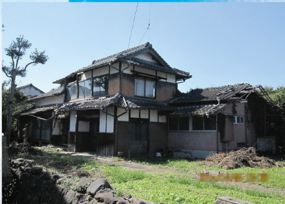
解体前の老朽危険家屋
