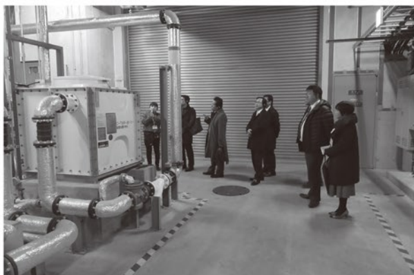
あべのハルカスの地下施設の様子
