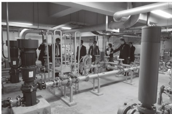
山口市環境センターの圧送設備の様子
